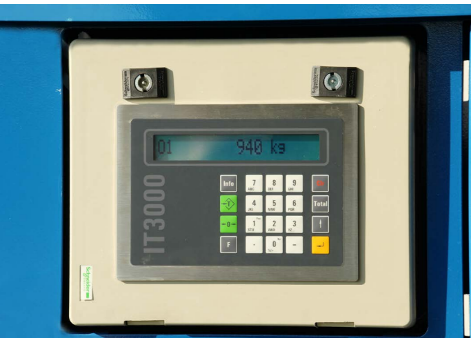
Displej v rozvaděči
